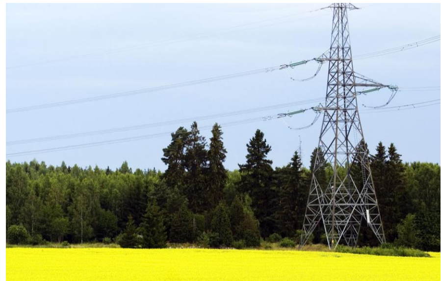
Kraftledning i Köpings kommun
